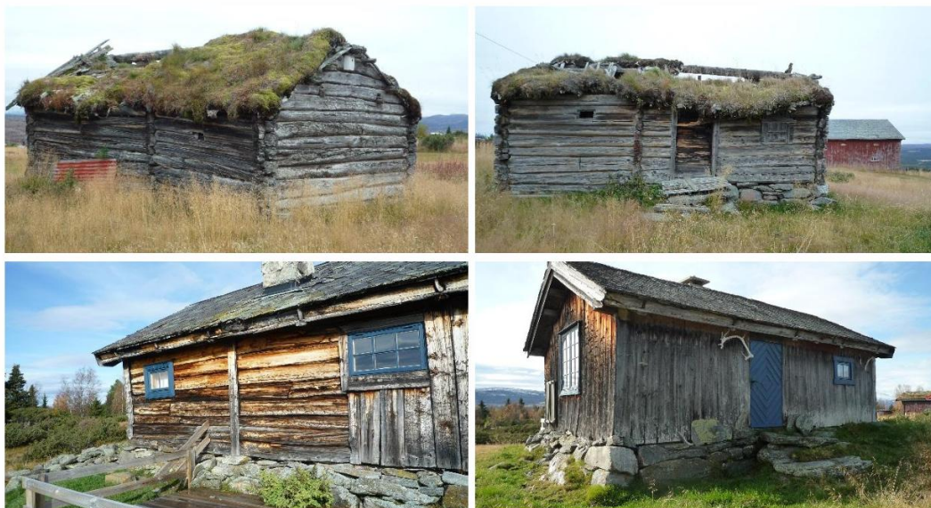
Todelt sel med mjølkebu i ei lengde – eit fråflytta og eit i bruk
